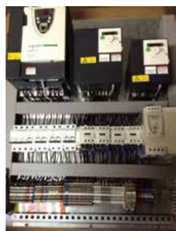
Painel de controle elétrico
