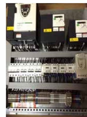
Painel de controle elétrico
